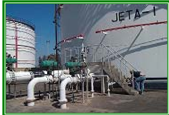
儲槽管線出入口
