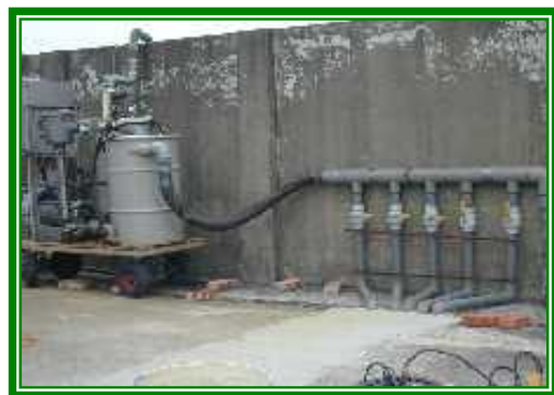
加油站 SVE 回收設備
