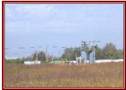
活性炭處理設施
